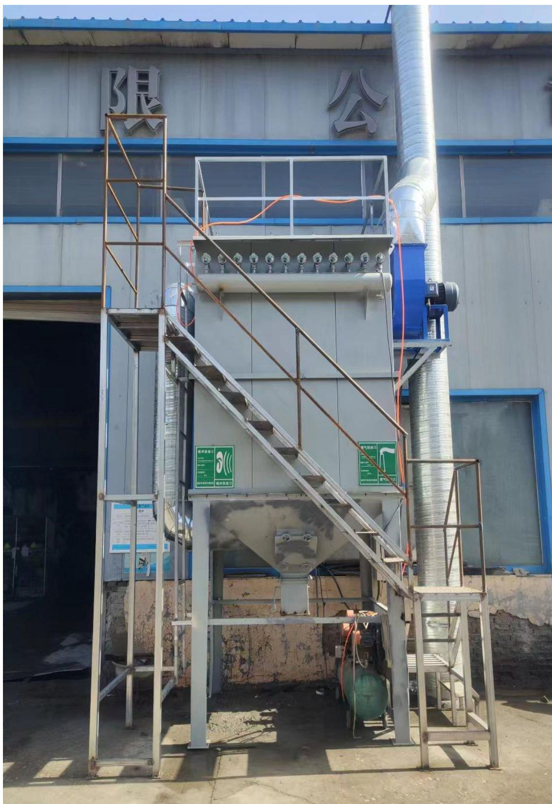
怀安县精武石材有限公司怀安县艺术石雕文化产业园项目环保设施现场照片
