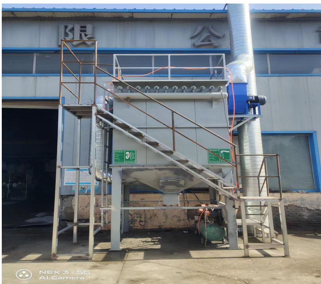
图 4-1 布袋除尘器+15 米排气筒
