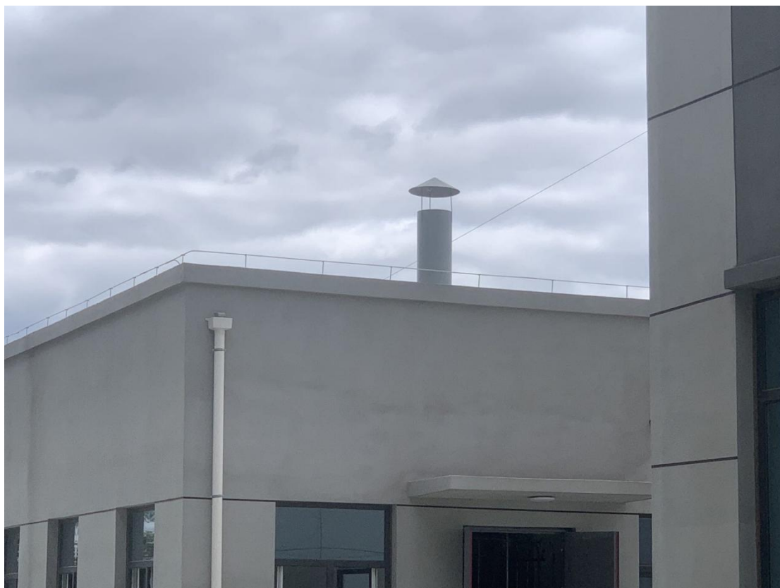
图 3-1 锅炉燃烧废气排气筒
