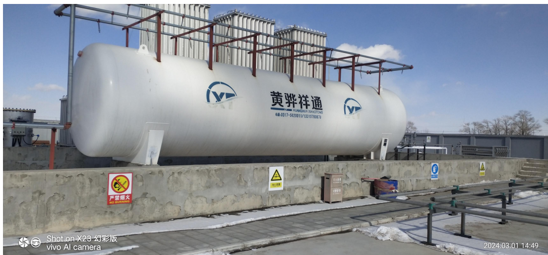
图 3-4 燃气储罐照片
