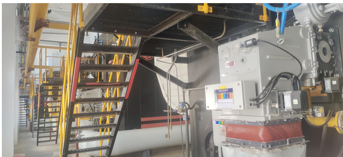
图 3-2 锅炉设备照片
