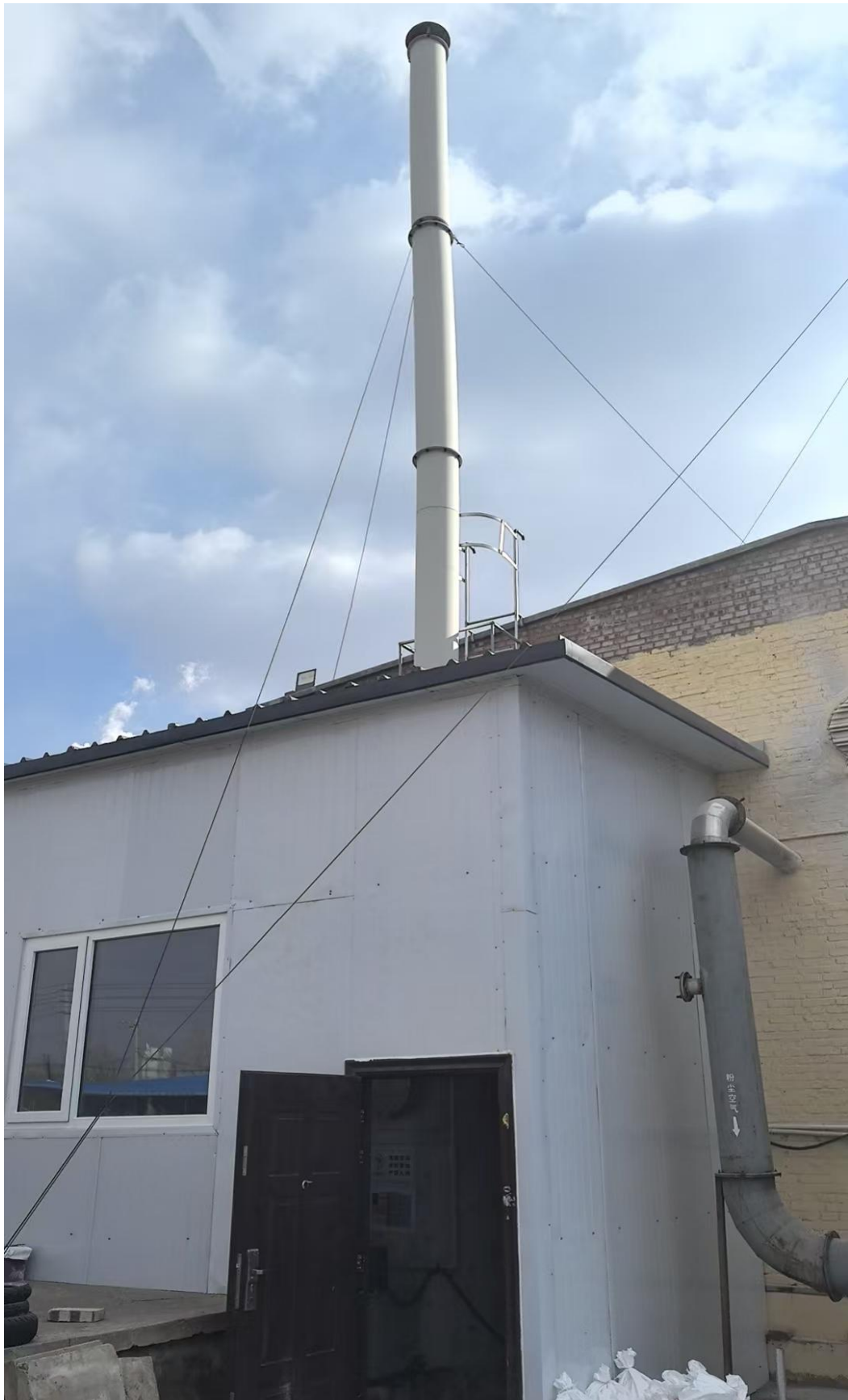
喷淋系统排气筒
