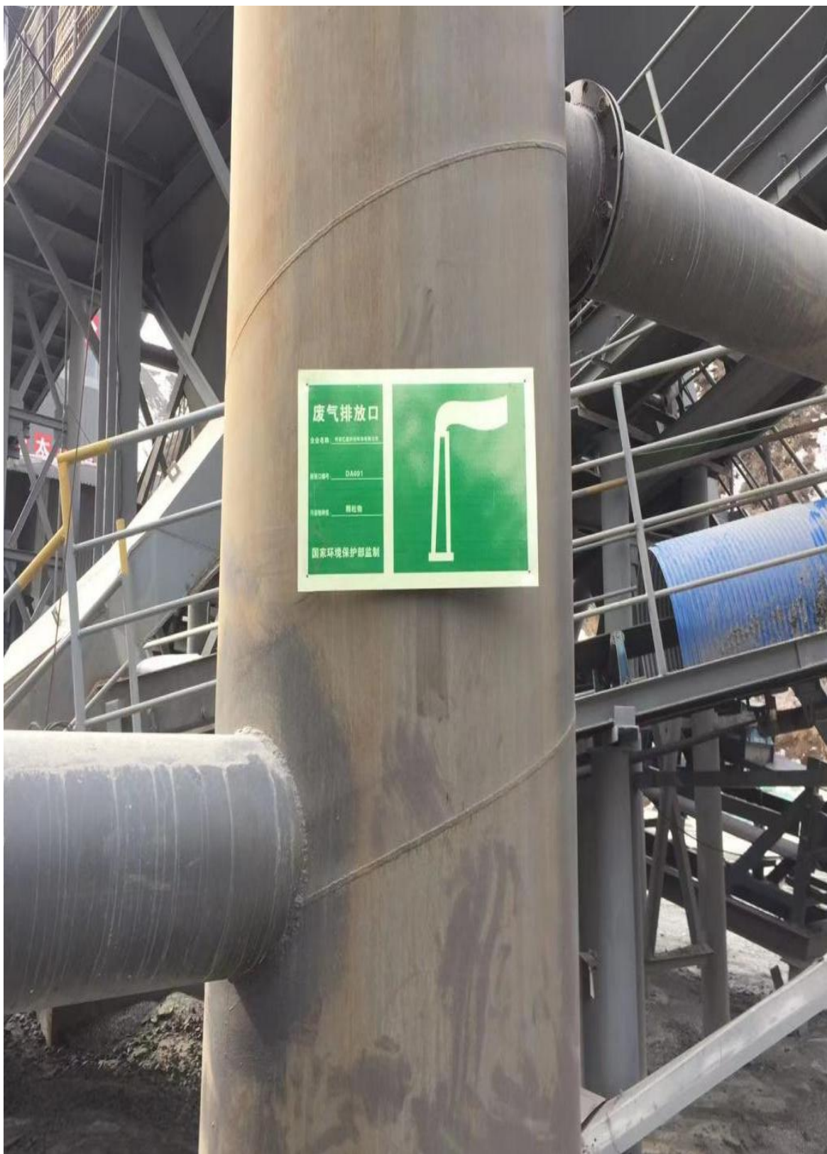
4.1-2 废气排污标志牌照片
