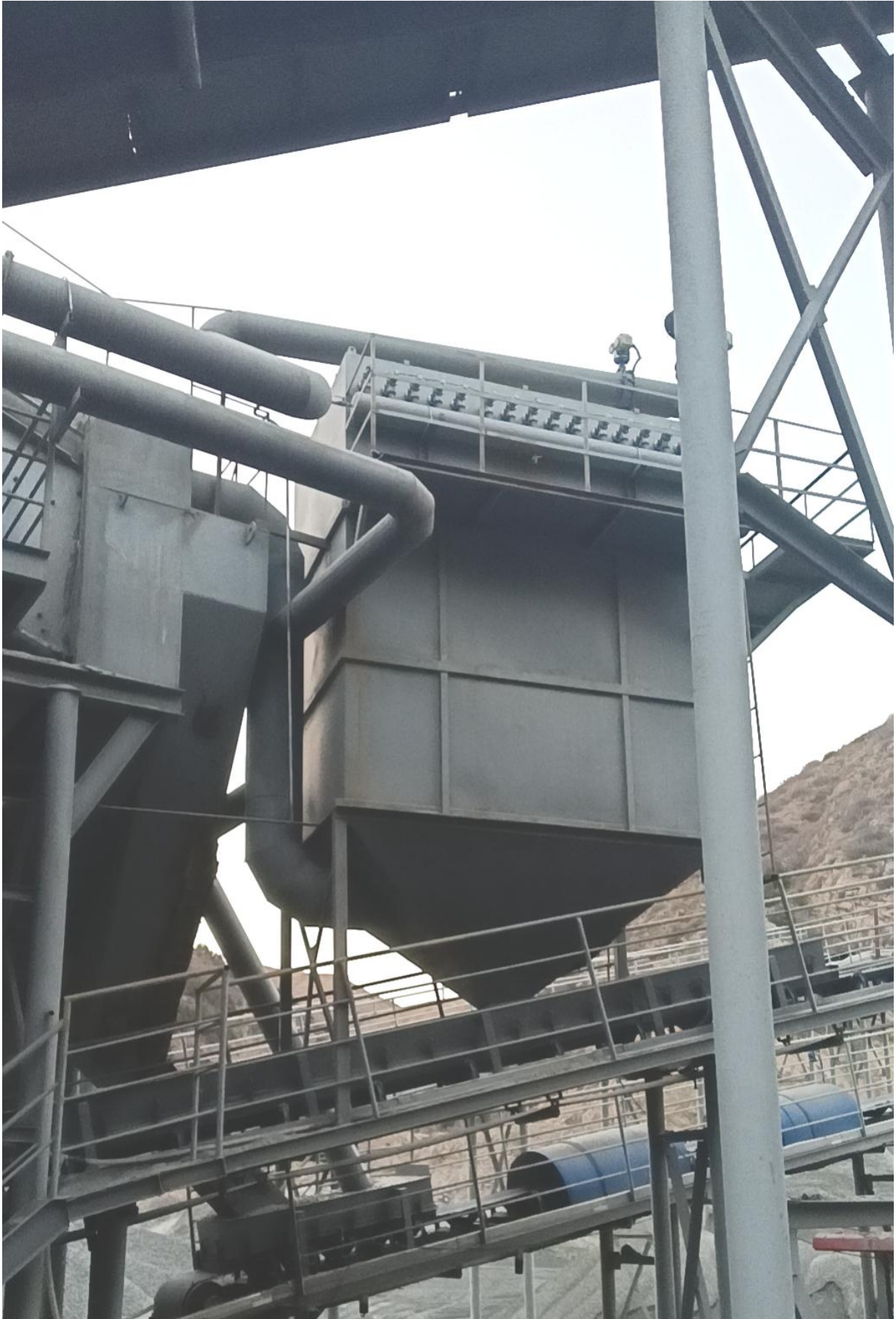
怀安县亿盛科技环保有限公司废矿石综合利用生态恢复治理工程项目环保设施现场照片
