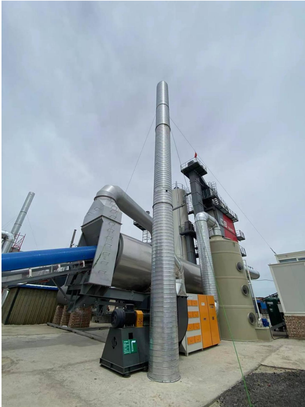
图5 沥青储罐呼吸废气、搅拌废气排气筒（DA003）现场照片
