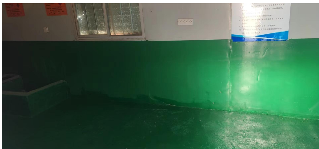
图 3-5 危废间现场照片
