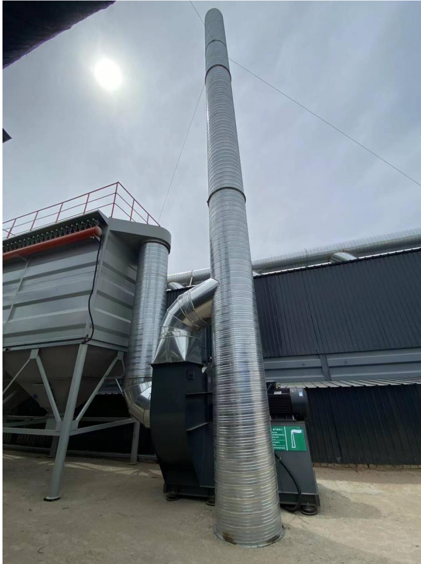
图 3-4 矿粉仓和冷料仓废气排气筒 (DA004) 现场照片
