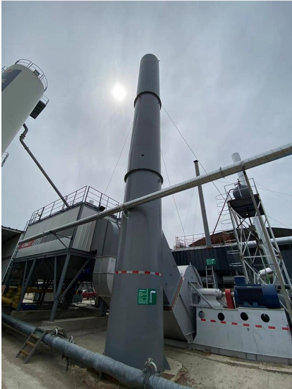
图 4 燃烧器废气排气筒 (DA002) 现场照片
