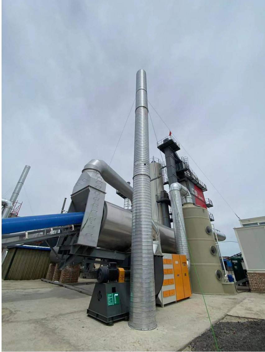
图 3-3 沥青储罐呼吸废气、搅拌废气排气筒 (DA003) 现场照片
