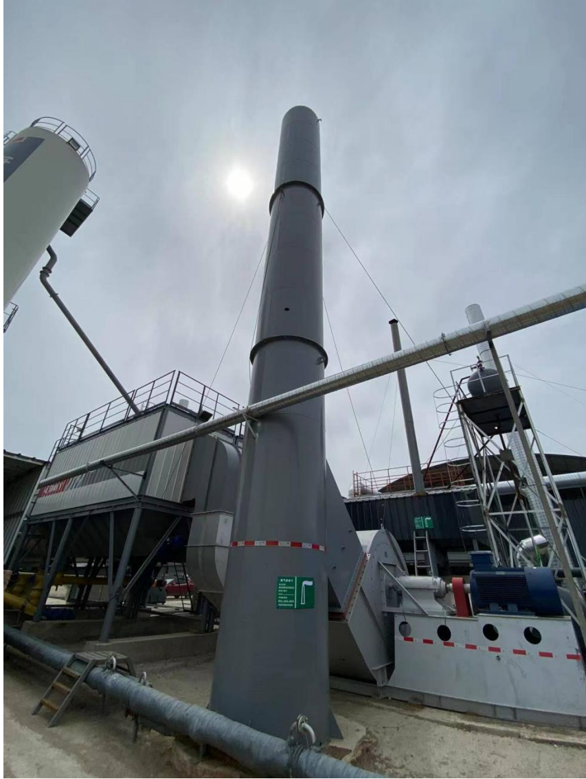
图 3-2 燃烧器废气排气筒 (DA002) 现场照片
