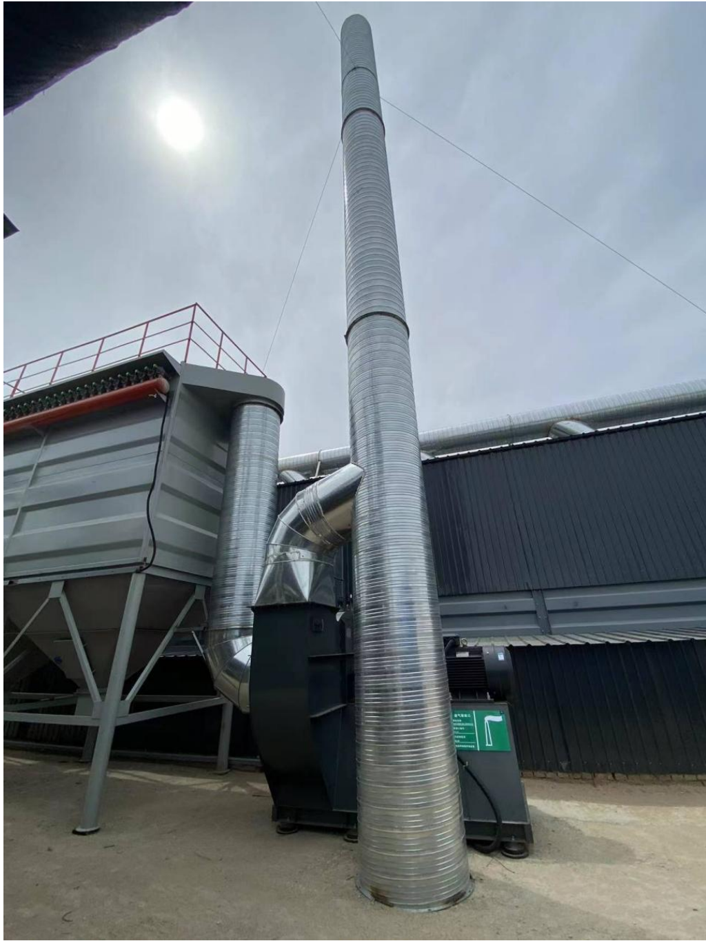
图 6 矿粉仓和冷料仓废气排气筒（DA004）现场照片
