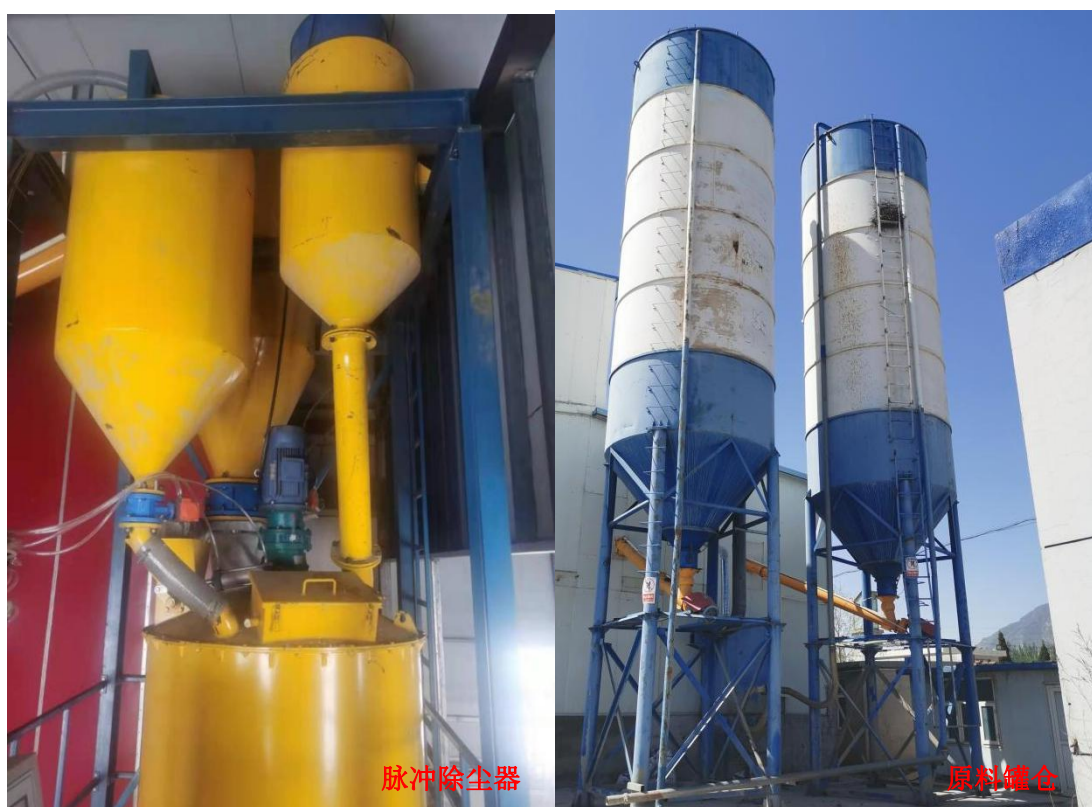
图 3-1 项目脉冲除尘器、原料罐仓照片
