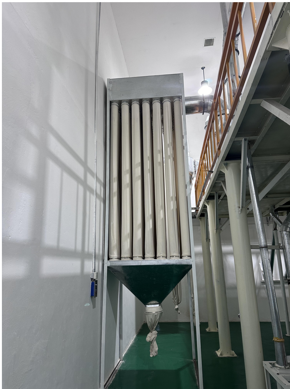
张家口图隆元食品有限公司玉米深加工项目布袋除尘器照片
