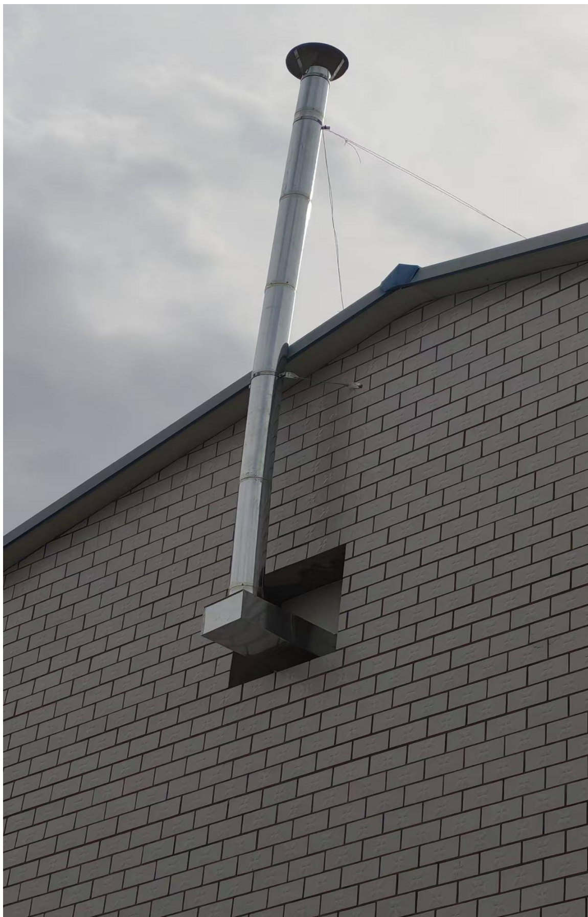
张家口图隆元食品有限公司玉米深加工项目排气筒照片
