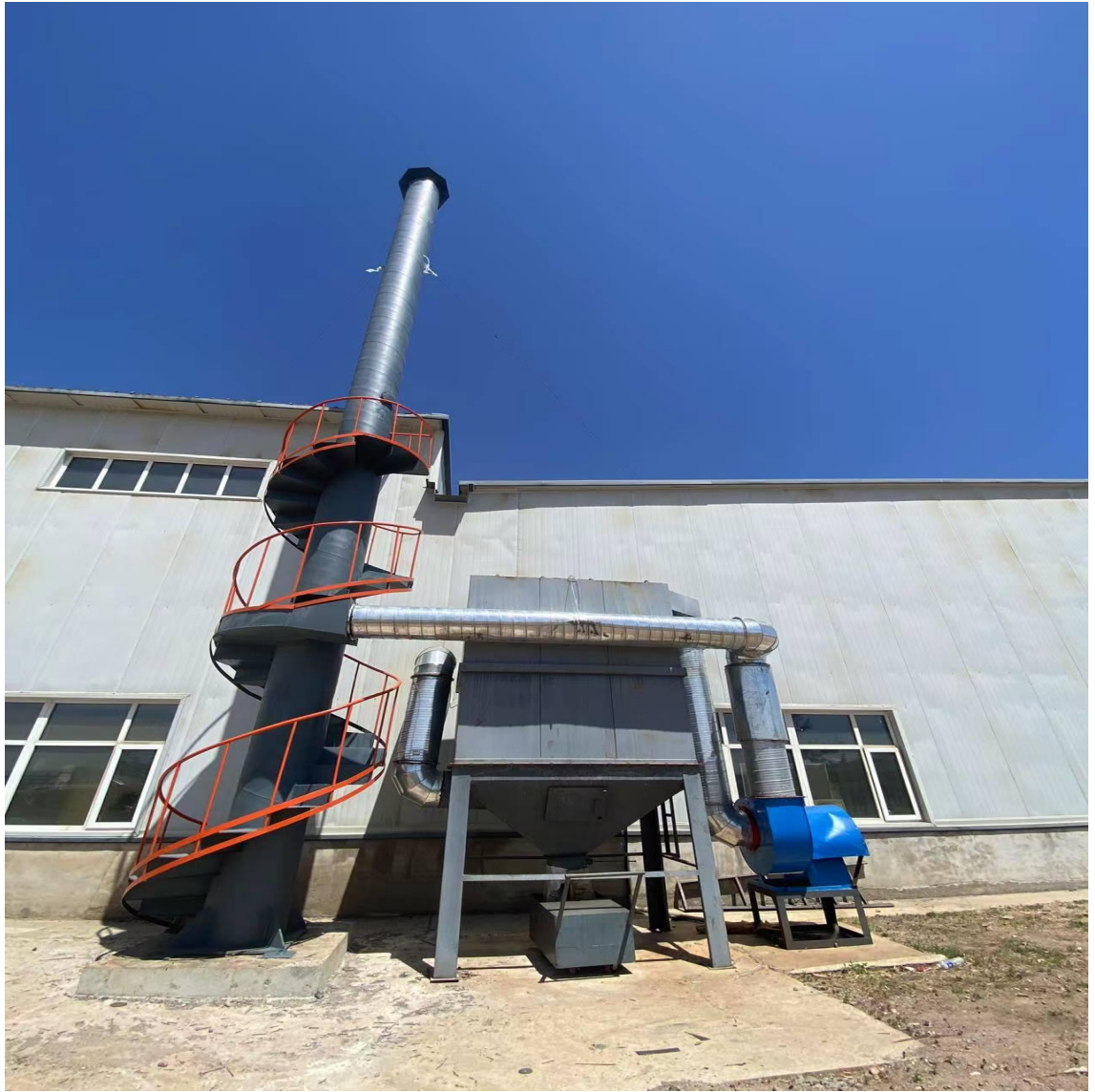
图3-6 处理等离子切割废气除尘器+排气筒
