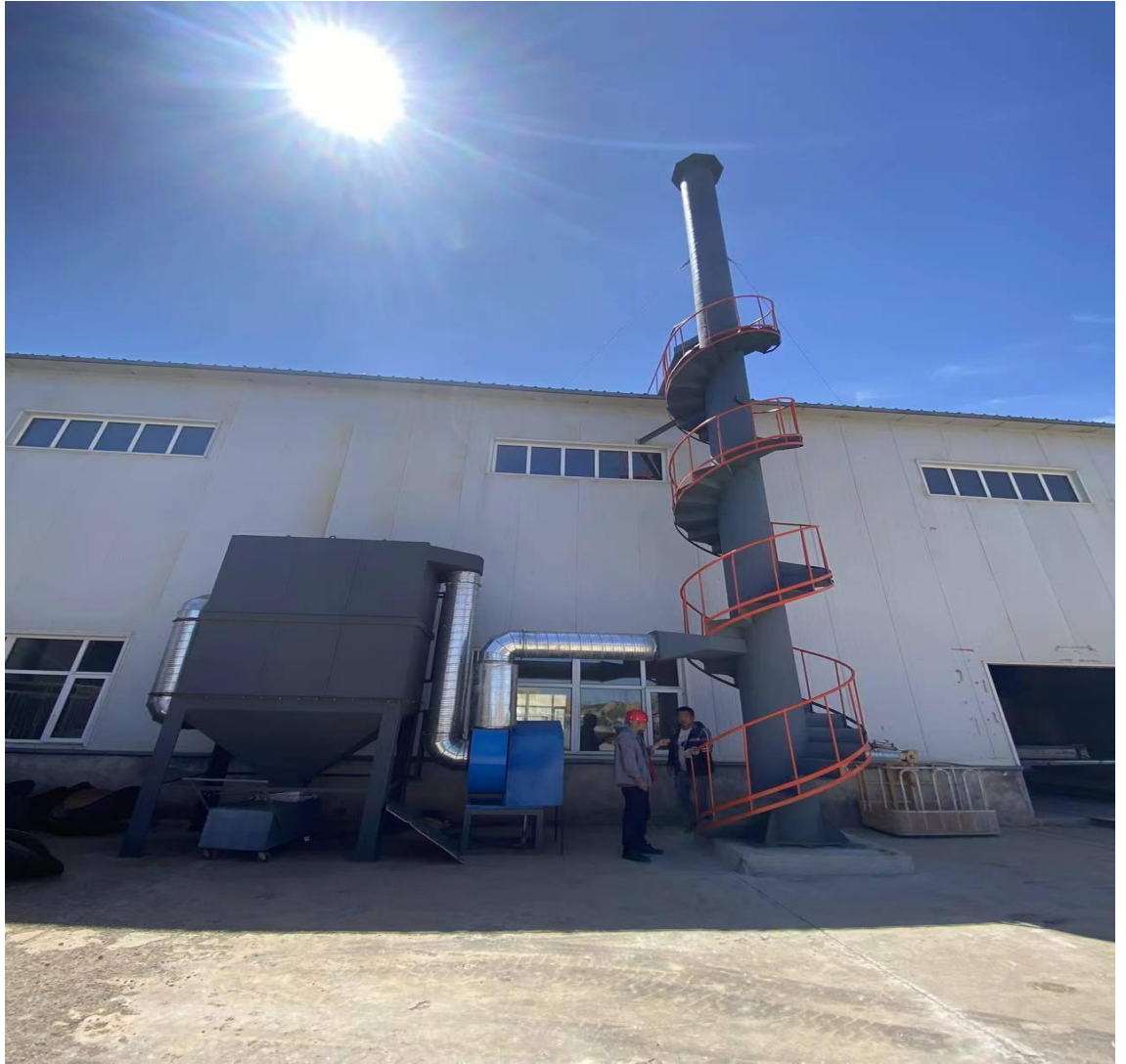
图3-5 处理激光切割废气除尘器+排气筒 等离子切割废气：经过布袋除尘器处理经过15m高排气筒排放（P6）。
