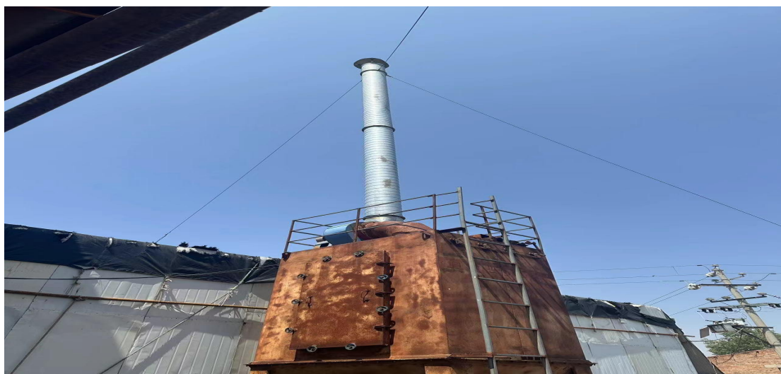
图 1 除尘器+排气筒
