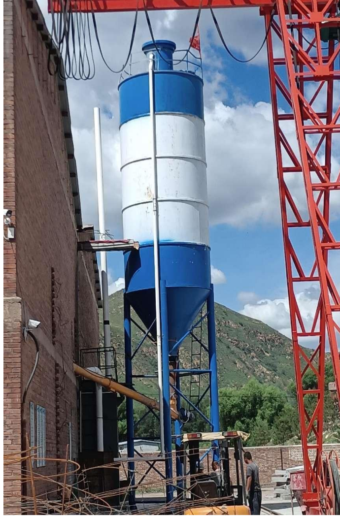
图 3-1 除尘设备及排气筒
