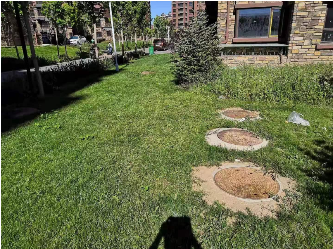
图 3-1 小区内化粪池
