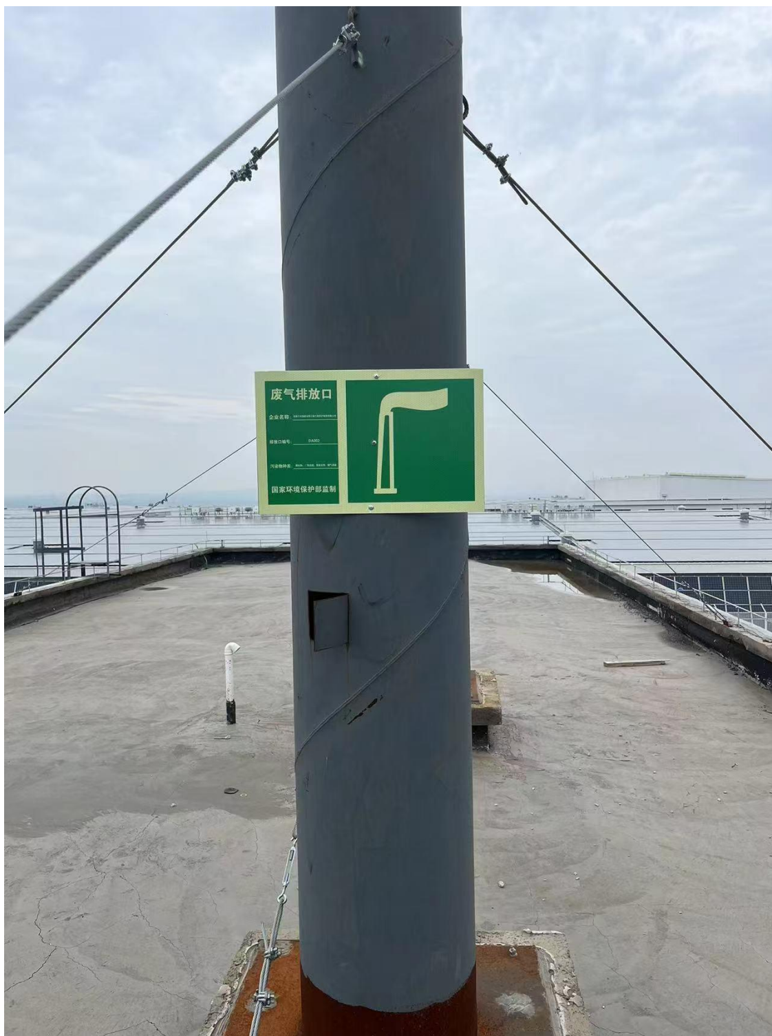
图 3-6 废气排放口现场照片 (P3)
