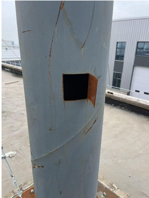
图 3-3 排气筒检测口 1
