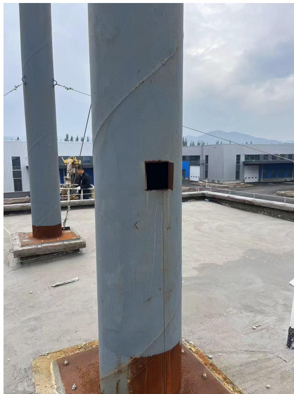
图 3-4 排气筒检测口 2
