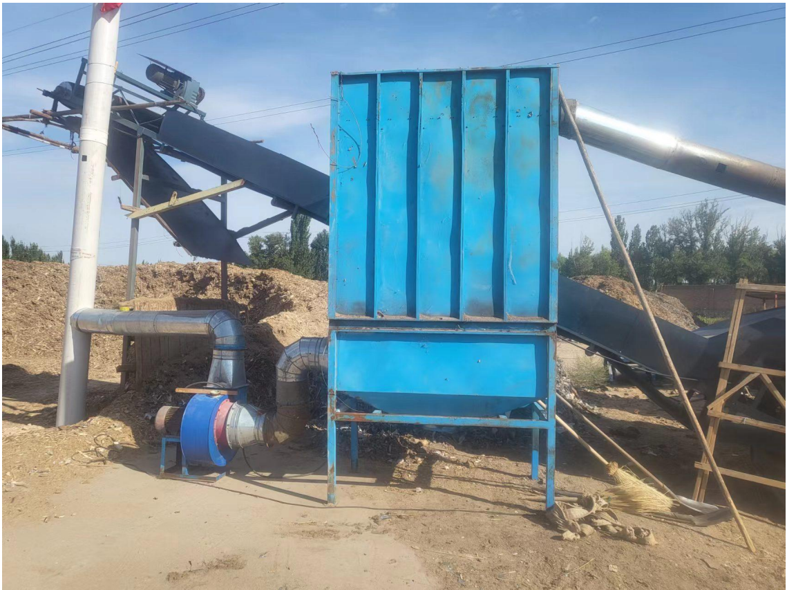
图 3-1 项目现场布袋除尘器照片
