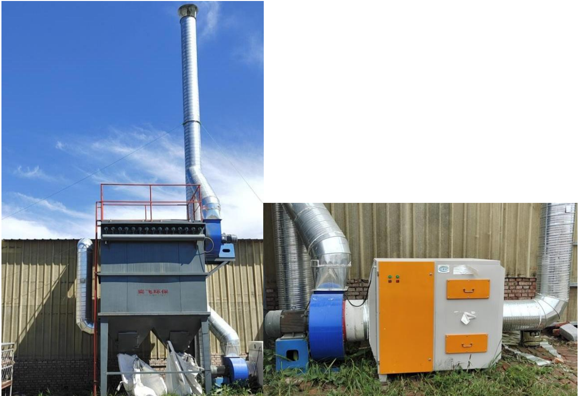
布袋除尘器+等离子+活性炭吸附+15m 高排气筒照片
