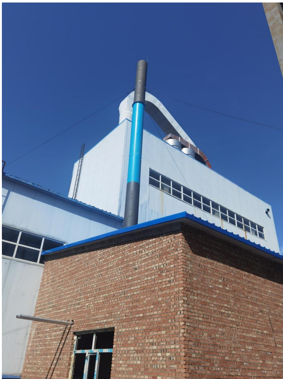
图 3-1 锅炉废气排气筒
